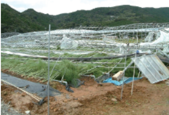
台風によるハウスの倒壊
