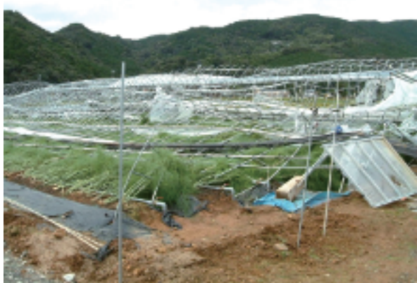
台風によるハウスの倒壊
