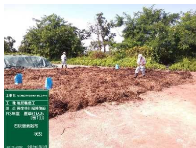
堆肥化の状況
