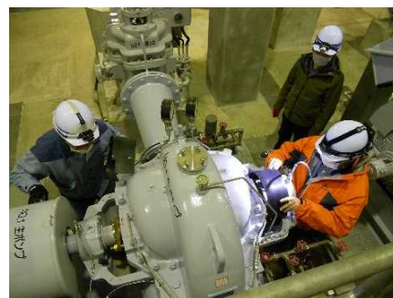
現地研修会（筑後川下流用水ポンプ）
