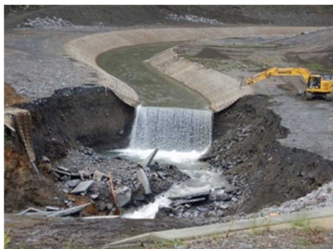
(河床水路の流出状況)
