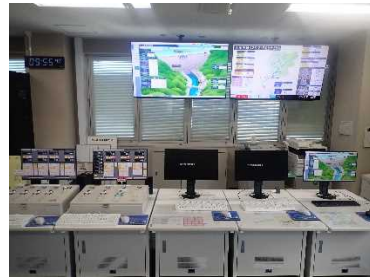
草木ダム管理用制御処理設備（整備後）
