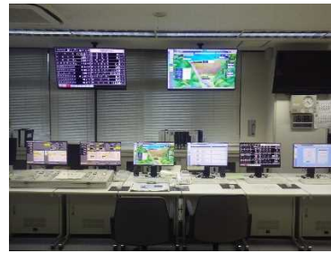
味噌川ダム管理用制御処理設備（整備後）
