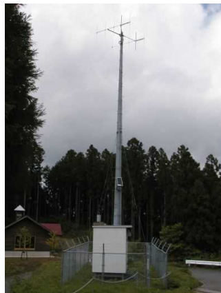
写真-1 雨量観測設備
