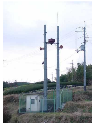
写真-2 警報設備
