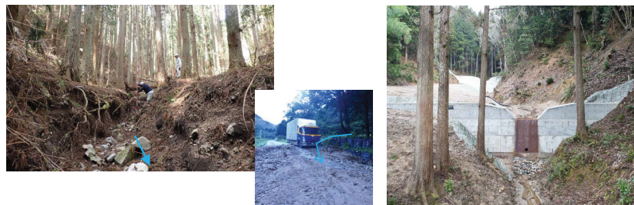
令和5年台風第13号により山腹が拡大崩壊し下流保全対象が被災
