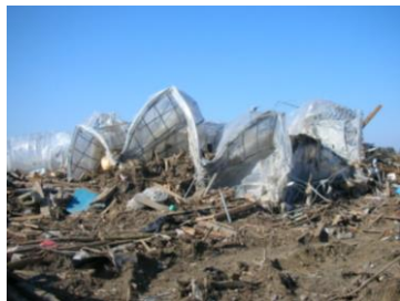
被災した園芸施設
