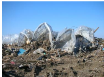
被災した園芸施設
