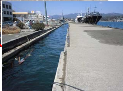
倒壊した岸壁
