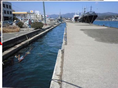
倒壊した岸壁
