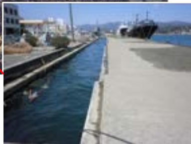
倒壊した岸壁
