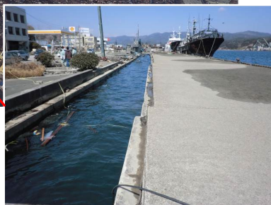
倒壊した岸壁
