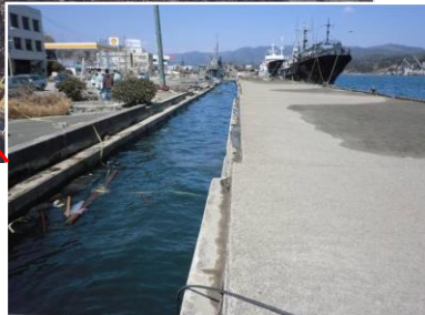
倒壊した岸壁
