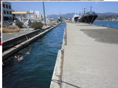
倒壊した岸壁
