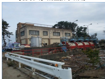
【名取川】関上排水機場
