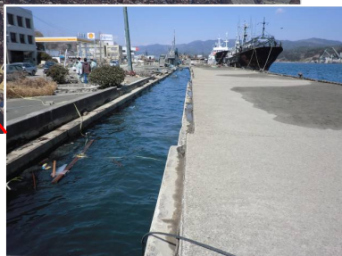
倒壊した岸壁
