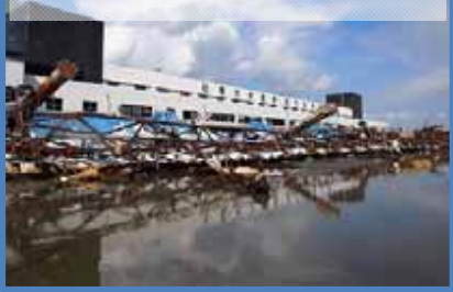
市場の倒壊、冠水
