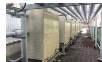
井水利用の地中熱利用ヒートポンプ
