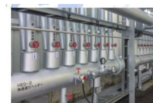
地中熱ヒートポンプはヘッダー側から個別に設置した
