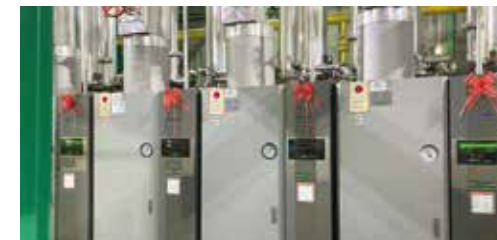
貫流ボイラー (インドネシア) DIC
