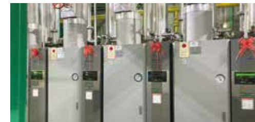
貫流ボイラー (インドネシア) DIC
