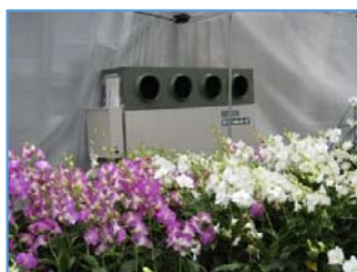
安定的採熱と ヒートポンプ利活用
