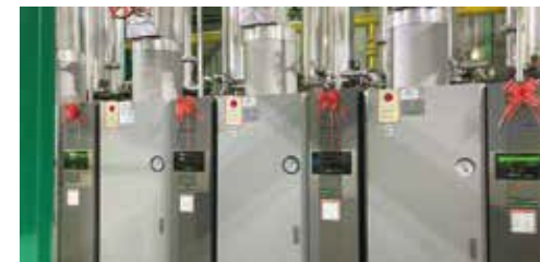
貫流ボイラー (インドネシア) DIC
