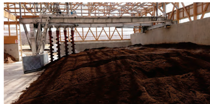
堆肥原料の自動攪拌機
