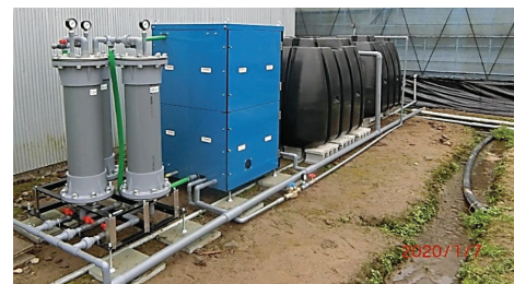
養液ろ過装置
