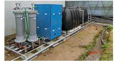
養液ろ過装置
