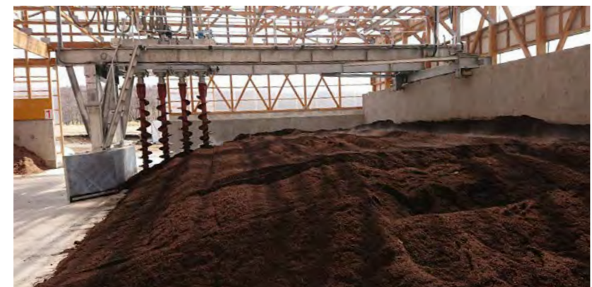
堆肥原料の自動攪拌機
