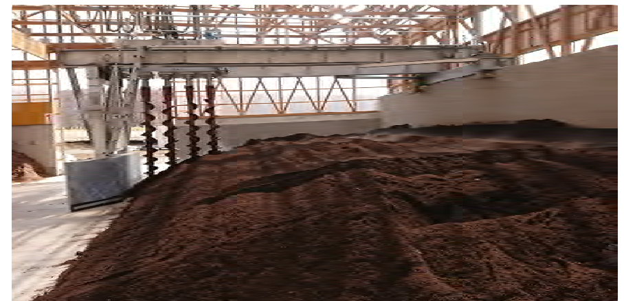
堆肥原料の自動攪拌機
