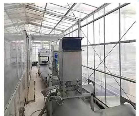
ほ場に接地する外気導入コリドー部分
