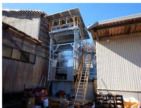
望月土づくりセンターの ペレット堆肥製造機械
