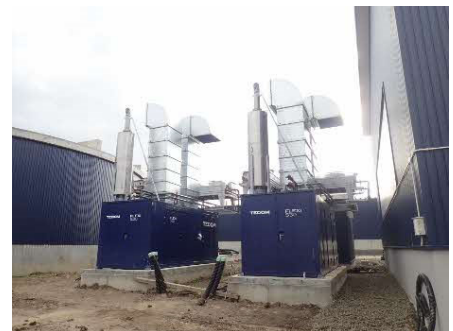
令和6年11月に設置された発電機
