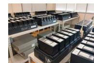
ドローンのバッテリー充電施設
