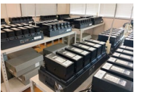
ドローンのバッテリー充電施設
