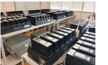
ドローンのバッテリー充電施設
