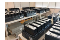
ドローンのバッテリー充電施設
