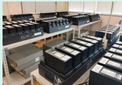
バッテリー保管・充電施設
