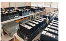
ドローンのバッテリー充電施設
