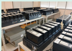
バッテリー保管・充電施設
