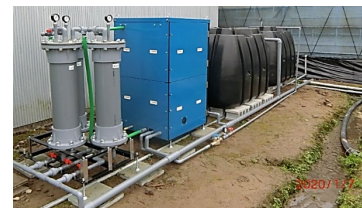
養液ろ過装置
