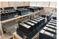
ドローンのバッテリー充電施設
