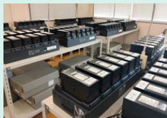
バッテリー保管・充電施設
