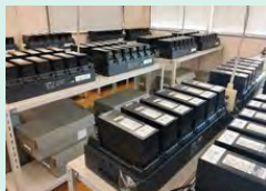
バッテリー保管・充電施設
