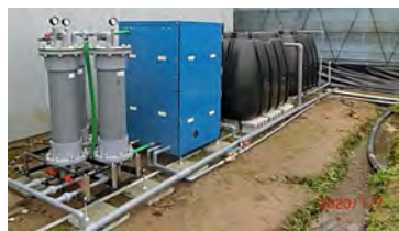
養液ろ過装置
