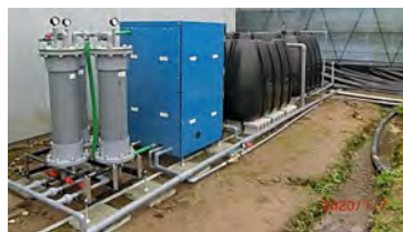
養液ろ過装置
