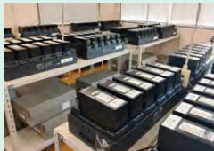
バッテリー保管・充電施設
