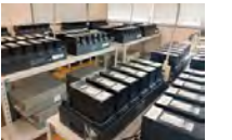
ドローンのバッテリー充電施設
