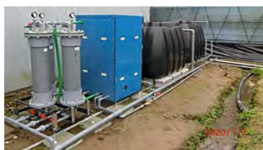
養液ろ過装置
