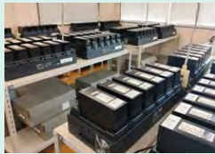
バッテリー保管・充電施設
