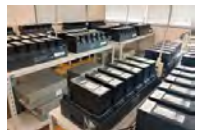
ドローンのバッテリー充電施設
