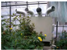
施設園芸用ヒートポンプ
