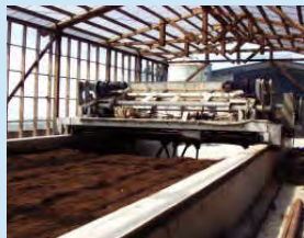
メタンの排出抑制、 良質な堆肥生産に資する 堆肥化処理施設
