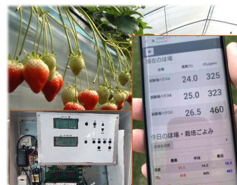
環境データをモニタリングし、制御する「さぬきファーマーズステーション」
