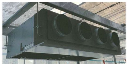
ヒートポンプの導入等による省エネ対策
