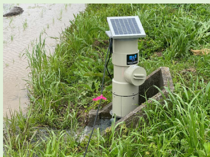
○ほ場水管理システム
