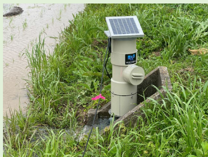
○ほ場水管理システム
