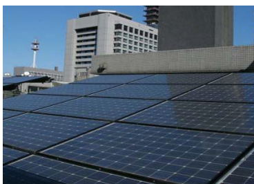
本省屋上を利用した太陽光発電
