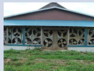
畜舎壁面の換気扇
