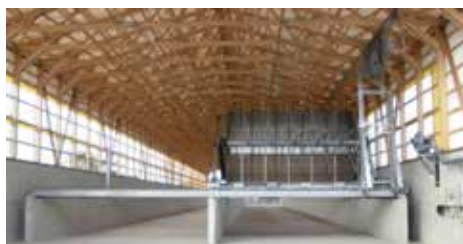
トラバーサー式ロータリー 発酵機
