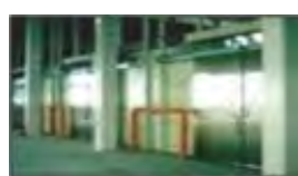
冷凍用機械装置
