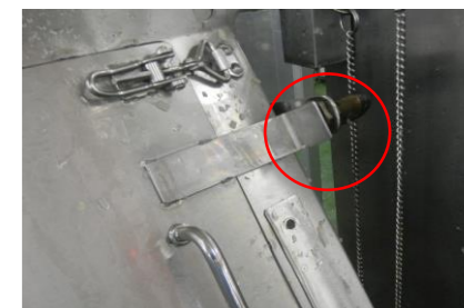
▲カバーにリミットスイッチを設置した例
